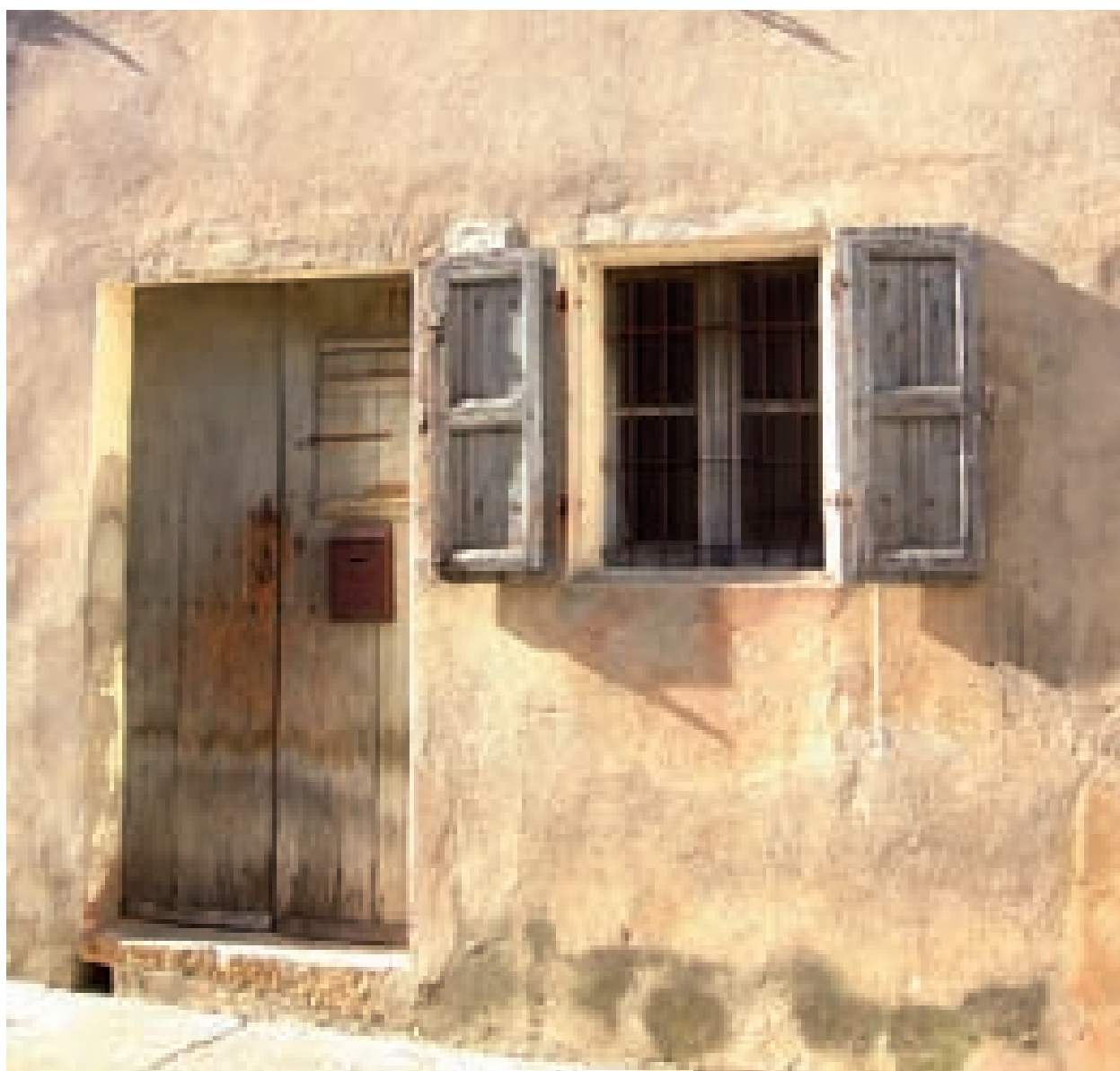
Fig. 3.77. San Vito. Porta e finestra con infissi privi di telaio fisso.
