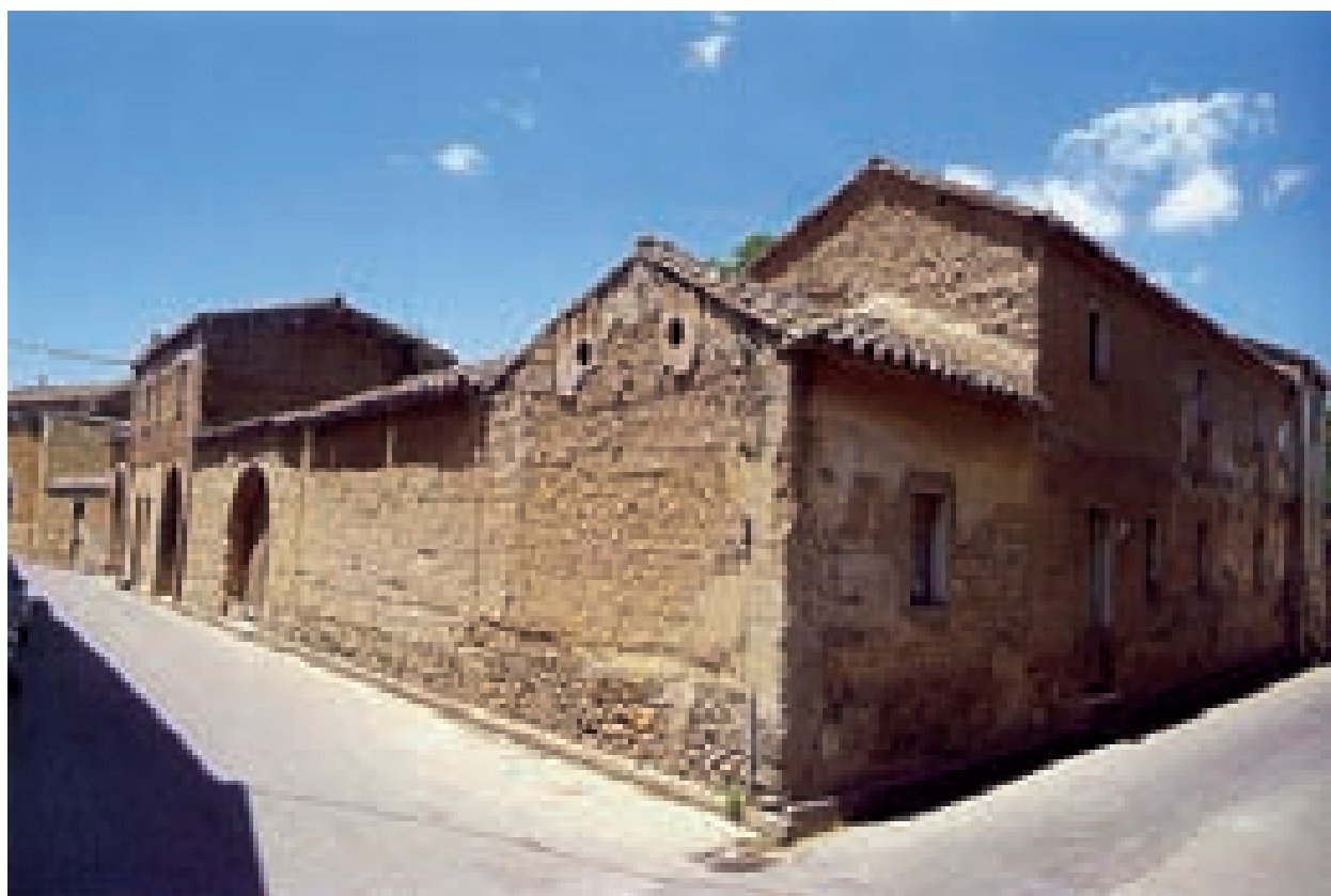
Fig 4.1. Degrado della superficie muraria. Serramanna, nel Campidano centrale.
