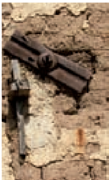
Fig. 3.149. Tramatzà. Capochiave metallico e capochiave ligneo accostati a testimonianza di un successivo intervento di contrasto delle spinte di ottimizzazione del sistema di solidarizzazione tra solai intermedi e murature perimetrali.
