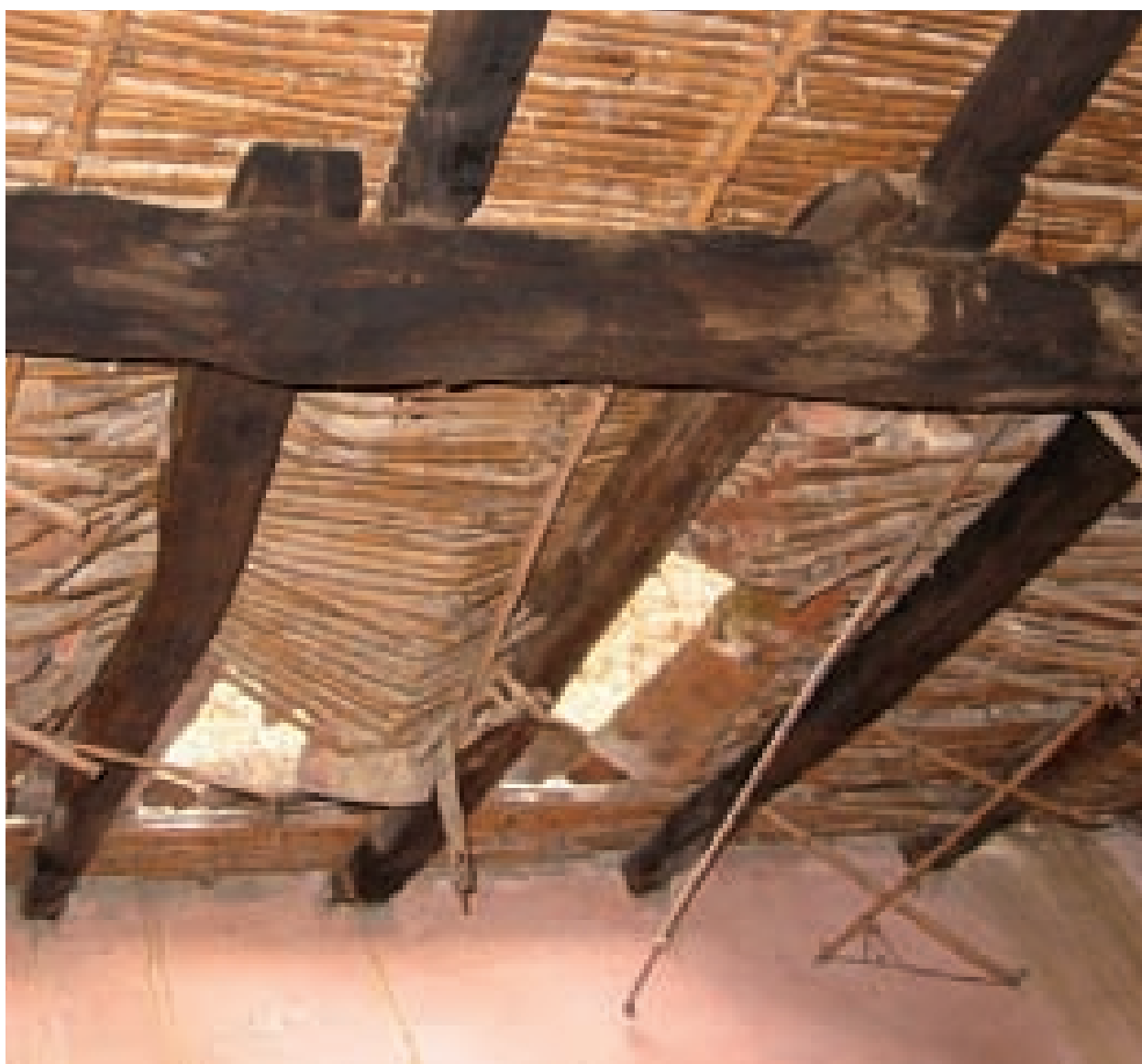
Fig. 4.48. Dissesti negli impalcati di copertura. Le infiltrazioni d’acqua, a seguito del degrado dei coppi, producono il rapido deterioramento dell’incanniccio che storicamente era soggetto a periodici rinnovi. Si pone oggi sempre più frequente l’ipotesi di una sostituzione dell’incanniccio con un tavolato ligneo integrato con manti impermeabilizzanti.
