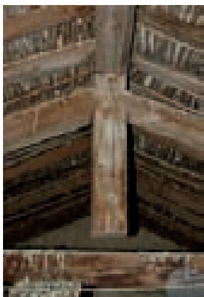
Figg. 3.123, 3.124 e 3.125. Siliqua, Serrenti, Assemini. Esempi di monaco. Nel primo caso il monaco non è collegato alla catena, nel secondo caso il collegamento è realizzato con una tavola chiodata, nell'ultimo mediante piastra metallica.
