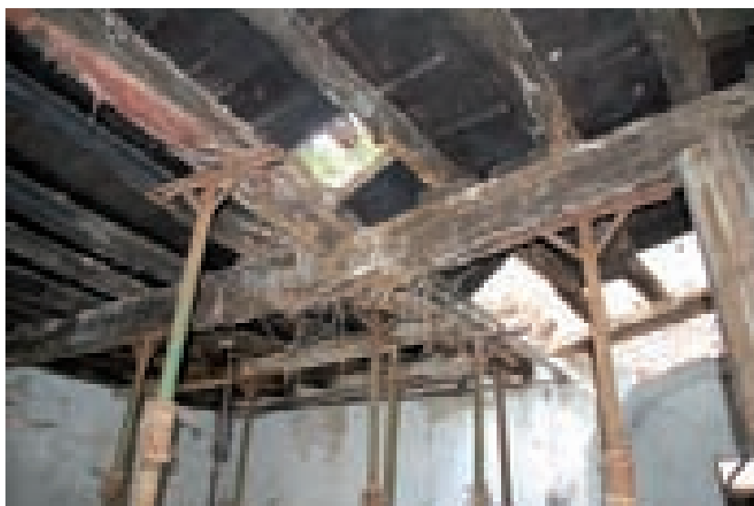
Fig. 4.55. Solaio ligneo a doppia orditura a Santuri, nel Campidano Centrale. Messa in sicurezza di un solaio pericolante in cui si è verificata la rottura della trave rompitratta e lo sfondamento dell’impalcato in tavole.
