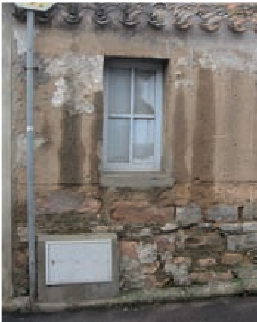
Figg. 4.61, 4.62. Degrado determinato dal posizionamento errato e invasivo degli impianti. Gonnosfanadiga, nel Campidano centrale e in basso Pabillonis, sempre nel Campidano centrale.
