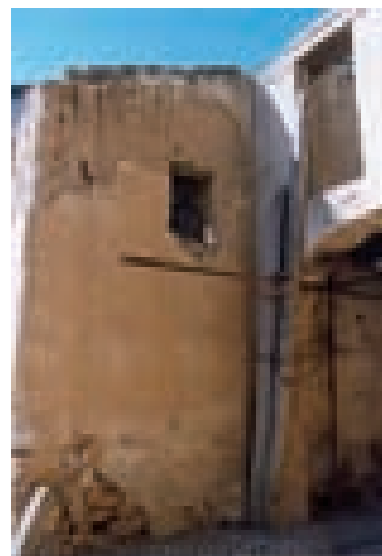
Figg. 3.36, 3.37. Vista dei fabbricati residenziali dalla prima corte, dettaglio del degrado delle murature e delle superfici intonacate.
