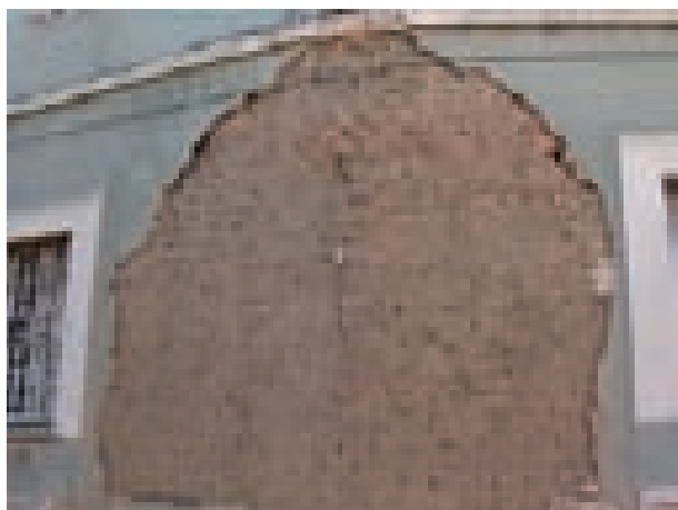
Figg. 1.16a, 1.16b. Distacchi di intonaco con legante costituito dal moderno cemento.
