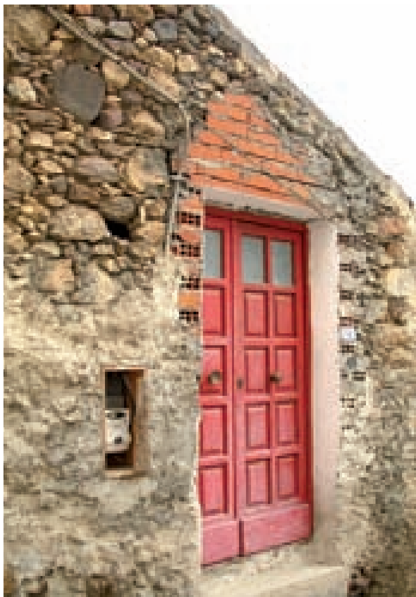
Figg. 4.70, 4.71. Degradi determinati dal posizionamento errato degli impianti: due esempi a Galtelli e Ilbono.
