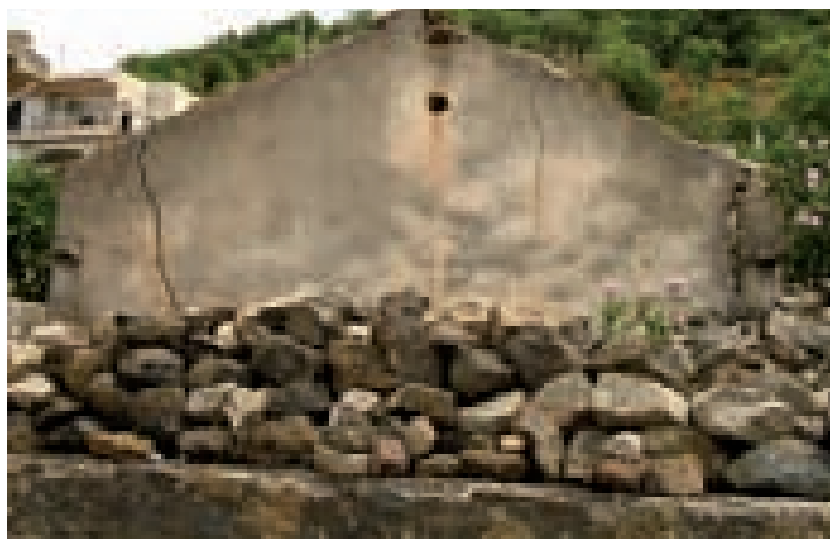
Fig. 4.4. Cedimento del piano fondale sulla parte sinistra e rotazione del muro nella parte opposta in una casa storica a Onifai.
