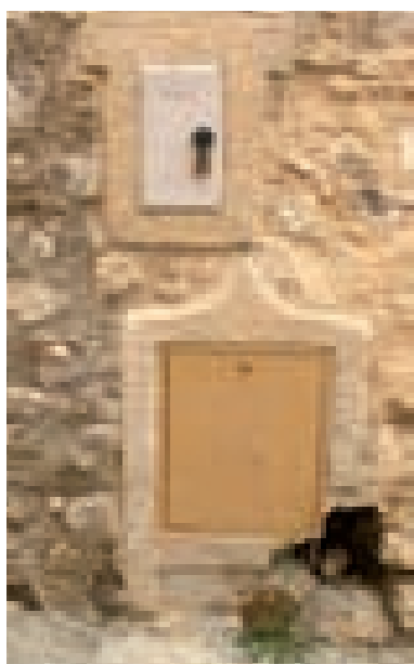
Figg. 4.68, 4.69. Degradi determinati dal posizionamento errato degli impianti: due esempi a Galtelli e Seno.
