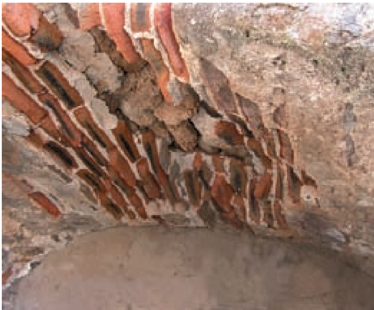
Fig. 4.60. Orosei, dissesto dovuto al deterioramento degli elementi componenti. I mattoni costitutivi della volta, di cattiva fattura e resistenza, presentano colorazione del nucleo differente rispetto a quella della superficie esterna indice di una cattiva cottura. Il distacco dei mattoni mette in evidenza il rinfilco realizzato in elementi lapidei di grossa pezzatura.
