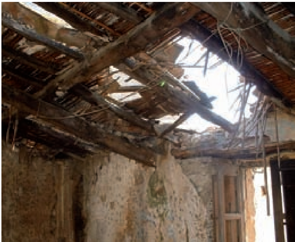
Figg. 4.46. Oliena: degrado estremo dell’incanniccio e del rivestimento di copertura.
