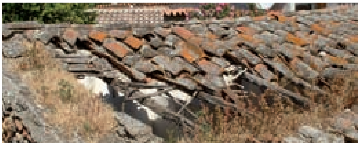
Fig. 4.45. Coperture: Orosei, degrado delle orditure lignee.
