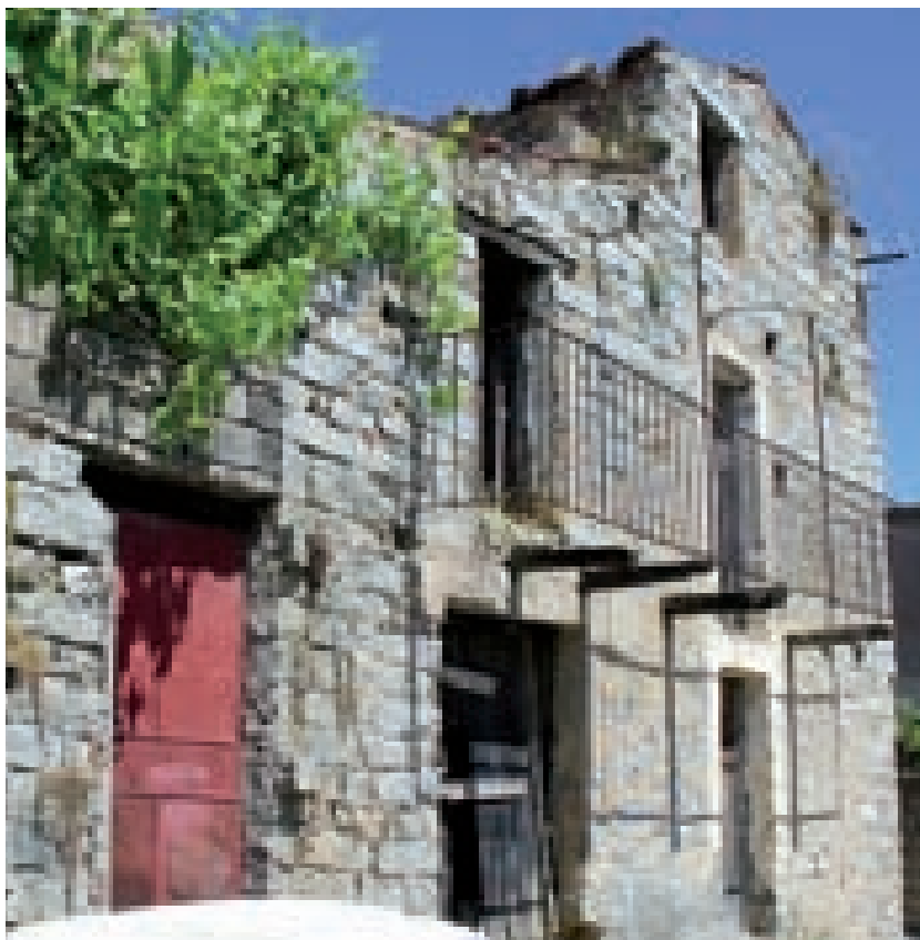
Figg. 4.40, 4.41. Ilbono: degrado delle aperture. Deterioramento degli sporti lignei e degrado dovuto all'uso di materiali incongrui, come il calcestruzzo cementizio.
