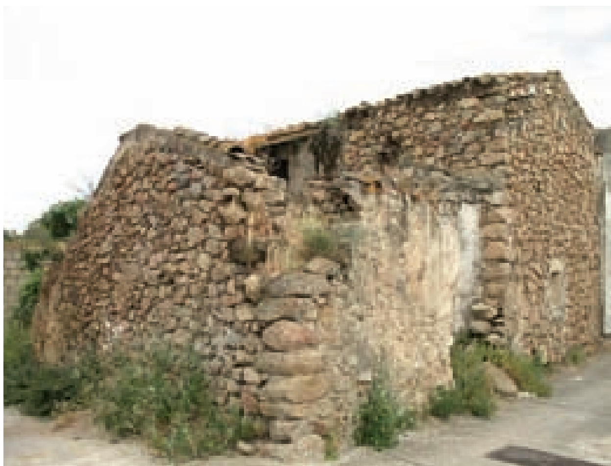
Fig 4.1. Loculi: degrado della scatola muraria. Dissesto della copertura e del cantonale.
