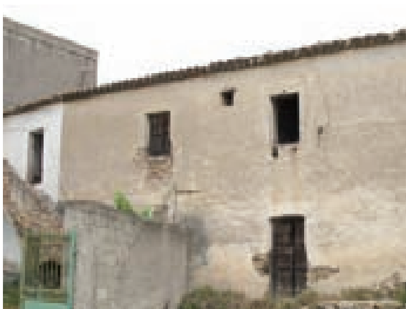
Fig. 4.28. Loculi. Lesioni dovute alle sollecitazioni trasmesse dalla copertura.
