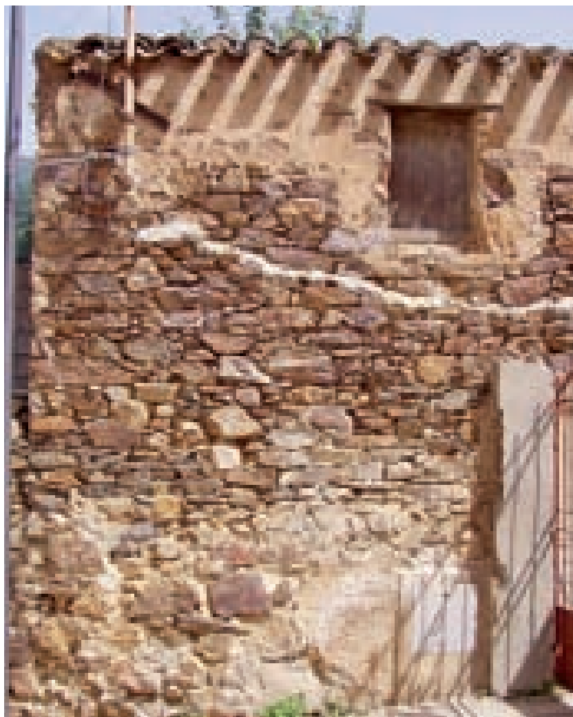
Figg. 4.42, 4.43. Degrado determinato dal posizionamento errato degli impianti. Due casi a Fluminimaggiore e Santadi.
