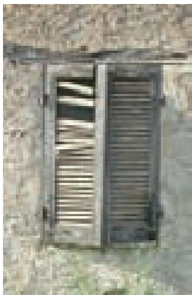
Fig. 4.21. Esempio di infisso in legno in avanzato stato di degrado a Nuxis.
