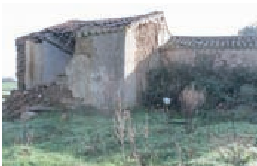
Fig. 4.4. Il degrado della scatola muraria. Cedimento di un setto murario in terra cruda nel Furriadrosciu Cadeddu, a Carbonia. Il patrimonio architettonico del Sulcis è caratterizzato dalla contemporanea presenza della pietra e della terra cruda.
