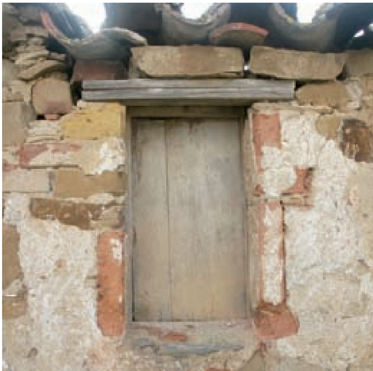
Fig. 4.17. Degrado delle aperture. Medau Manca, a Carbonia.
