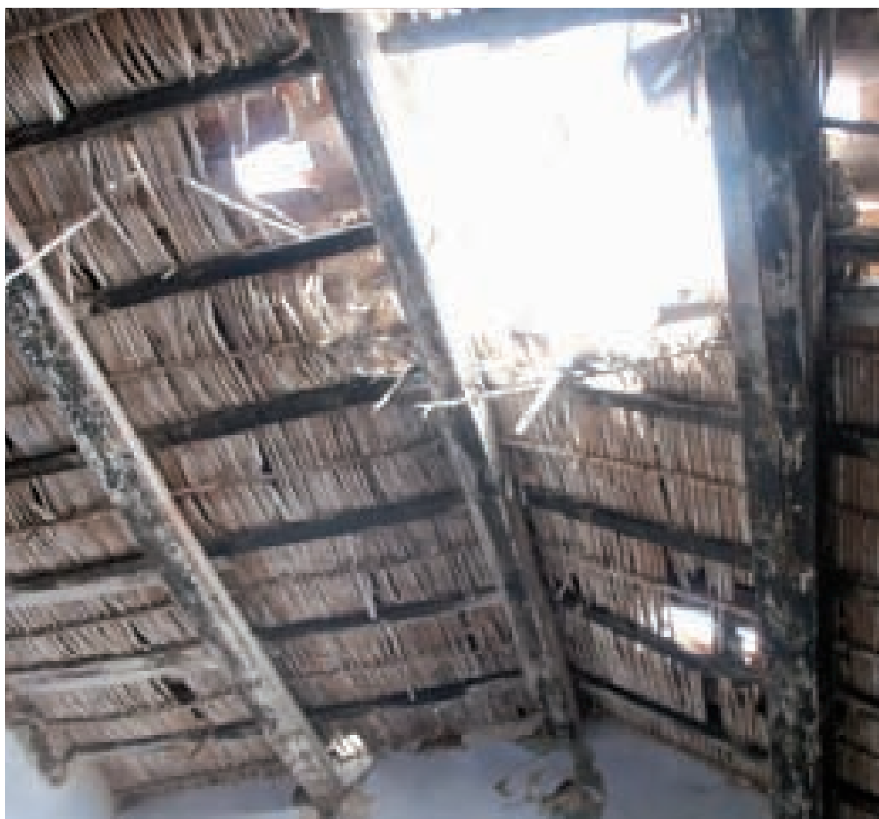
Fig. 4.27. Degrado dell’impalcato. Medau Fran, Carbonia.
