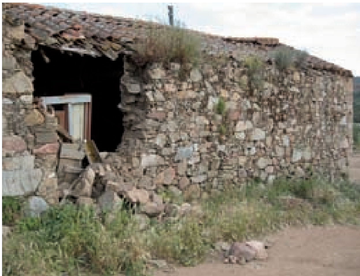
Fig. 4.7. Cedimento di una muratura dovuto alla spinta della copertura. Medau Tria, Teulada.
