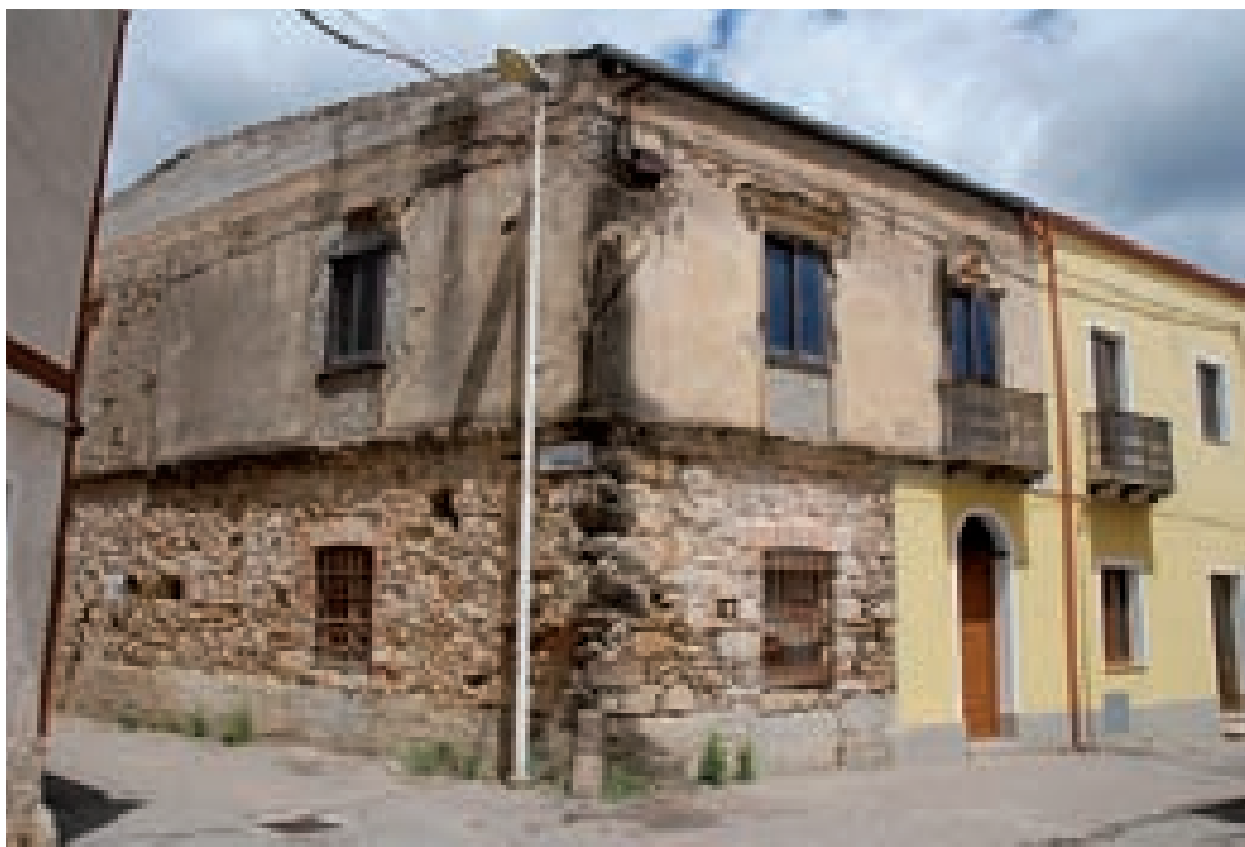
Fig. 4.8. Degrado di un edificio storico a Narcao, causato da mancanza di manutenzione e da modificazioni effettuate con tecniche incongrue e di bassa qualità. A destra, nella stessa foto, una porzione restaurata del medesimo edificio.
