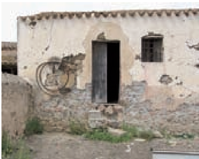
Fig. 4.15. Medau Cinffegan, a Teulada. Lesioni dovute alle sollecitazioni puntuali trasmesse dalle strutture della copertura.
