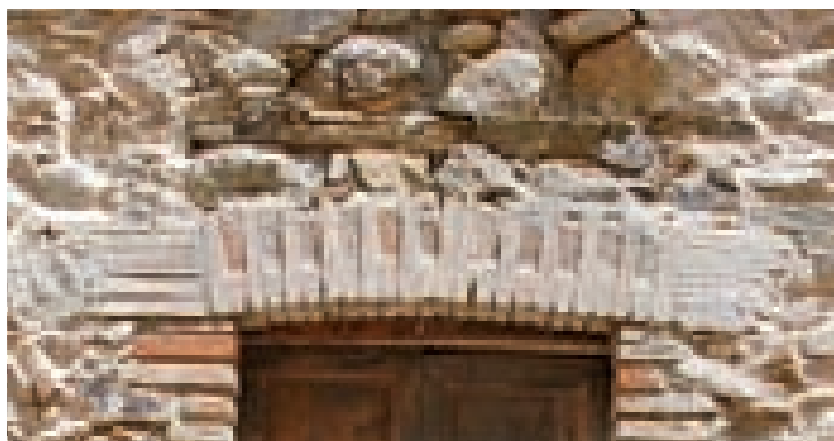
Fig. 3.42. Narcao. Piattabanda in mattoni laterizi poggiante su stipiti realizzati con lo stesso materiale opportunamente ammorsati alla muratura in pietra.
