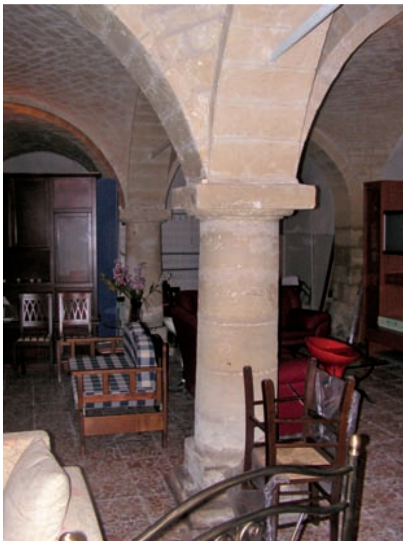
Fig. 3.8. Nulvi; dissoluzione delle murature nel piano terra di un palazzetto signorile. Gli archi inseriti al posto dei muri di spina raccolgono le spinte delle volte a vela e le scaricano sulle murature laterali e su due pilastri posti al centro dell'ambiente.
