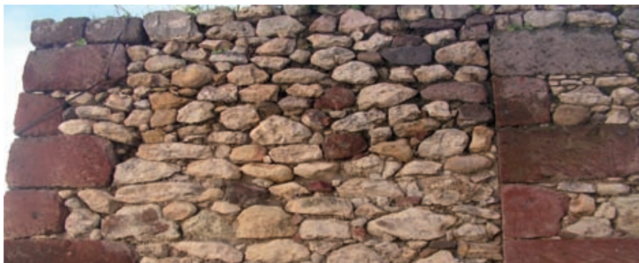
Fig. 3.15. Commistione di materiali lapidei con differenti proprietà meccaniche (Martis).
