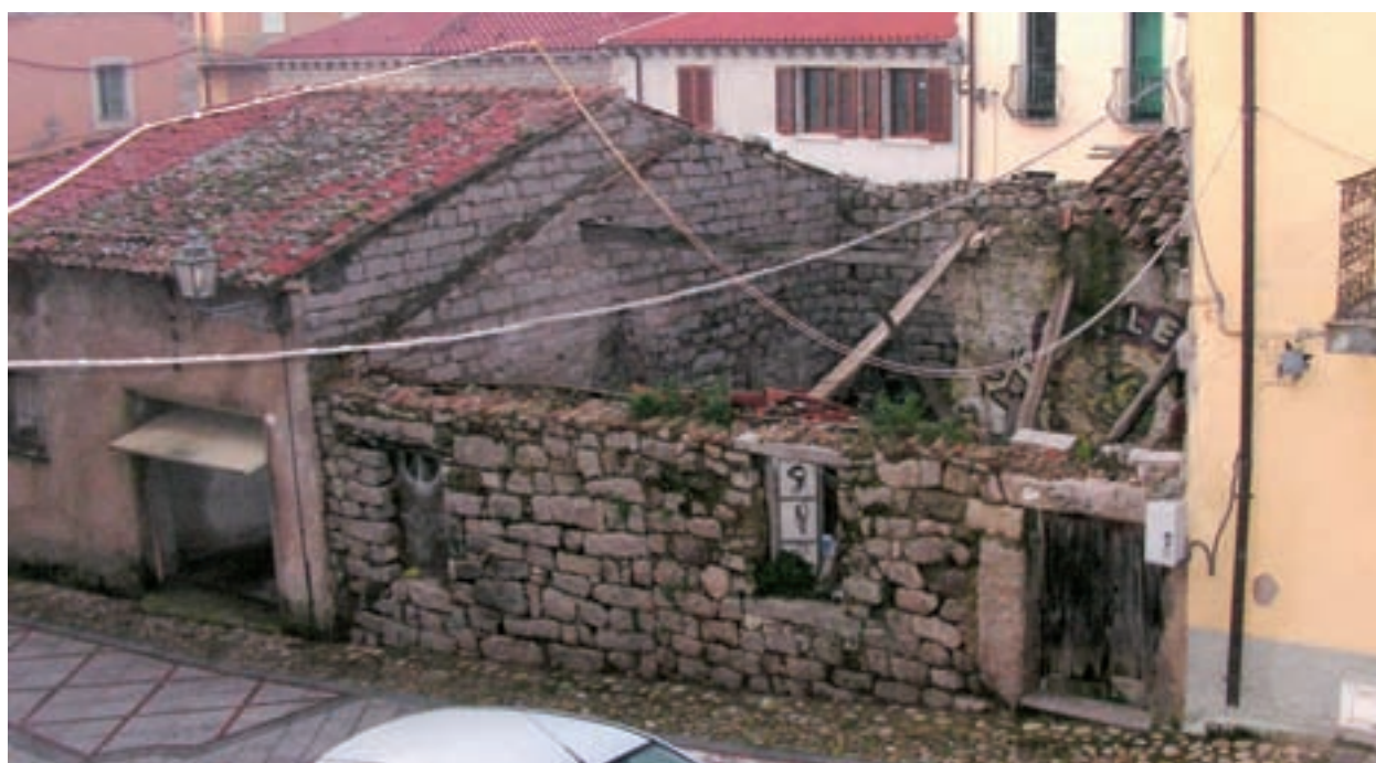
Fig. 3.9. Calangianus; il crollo della copertura in una abitazione a cellule mette in evidenza il diverso ruolo strutturale delle pareti mutualmente ortogonali.
